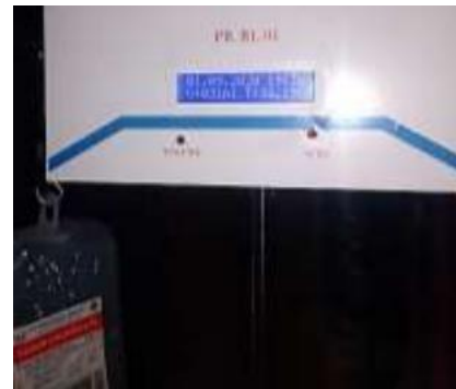
Gambar 7. Pengujian Panel Monitoring Pasien Ruang 01
