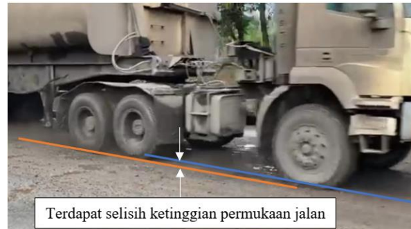
Gambar 5. Terdapat Selisih Ketinggian Permukaan Jalan
