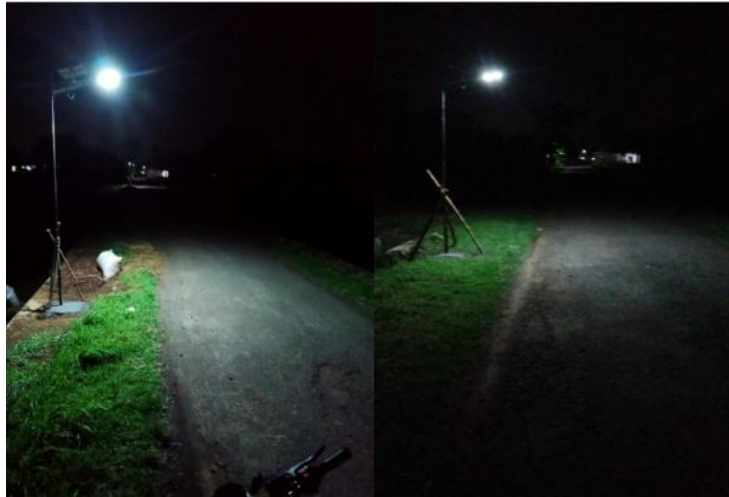
Gambar 10. Kondisi Lampu Penerangan Jalan yang telah terpasang di Desa Banjarwaru Pada Lokasi Pertama
