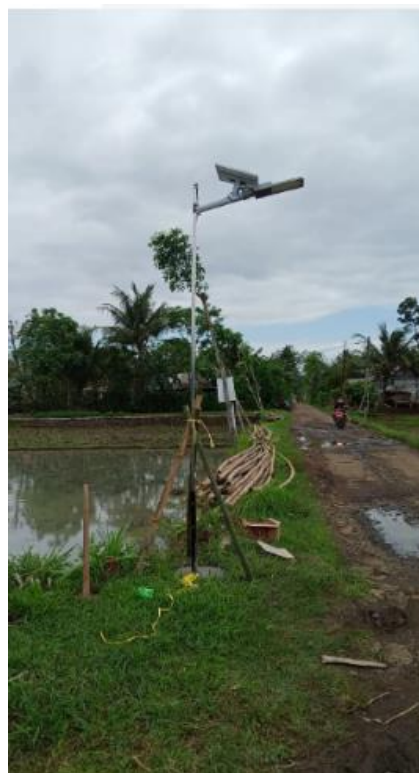
Gambar 11. Kondisi Lampu Penerangan Jalan yang telah terpasang di Desa Banjarwaru Pada Lokasi Kedua
